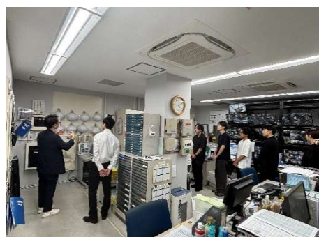
防災センター
